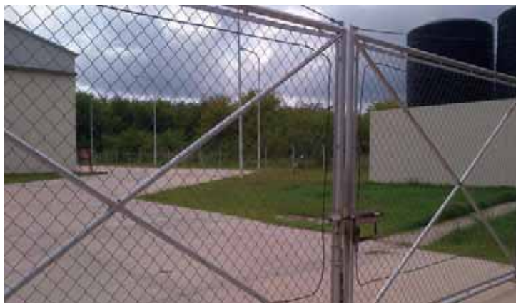
Sistema “triple” de CCTV, cable sensor de cercas y barreras de microondas instalado por USS en un depósito de alta seguridad.
