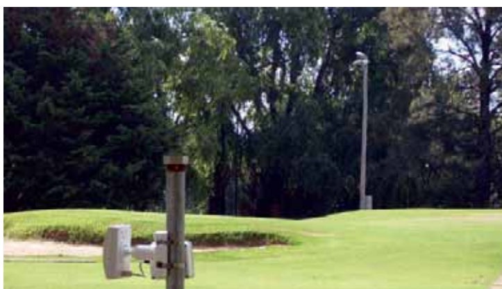
Sistemas de seguridad para countries combinando CCTV (al fondo) con sistemas de intrusión perimetrales por barreras de microondas (al frente).
